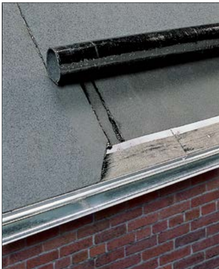
Figur 3.1: Hjørnet på overpappen snittes skråt af for at få en tæt og pæn afslutning.
