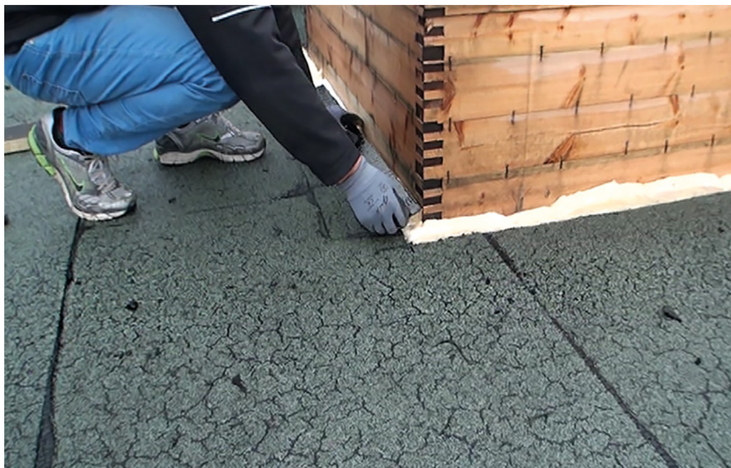
Foto 2: Lukning med brandfuge omkring ovenlys. Kilde: BYG-ERFA Brandteknisk lukning af spalter mod hulrum (37) 170604.
